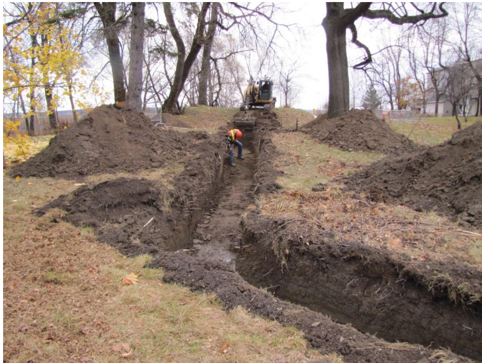
Figure 5. Vue de la tranchée 1D pratiquée dans la partie surélevée. En direction sud, photo Serge Rouleau, A12-09014.
