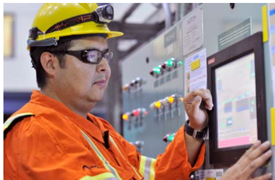
Jasmin Mowatt, électricien d'appareillage à la centrale de la Sarcelle
