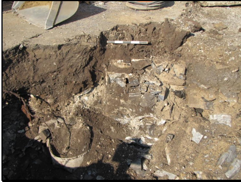
Figure 20. Vue de la fondation du mur de façade CeEt-435-2A2 dans la tranchée en bordure ouest de la rue. Photo Serge Rouleau, en direction nord, A11-13-07.
