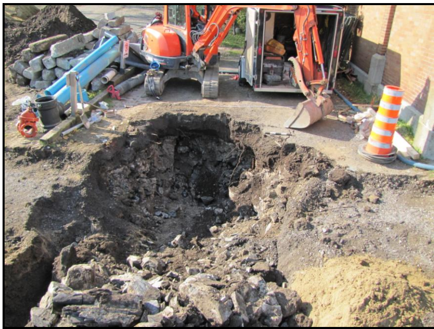
Figure 21. Vue de la fondation du mur de refend CeEt-435-2A3 et de la tranchée empiétant sur la propriété. Photo Serge Rouleau, en direction ouest, A11-13-07.
