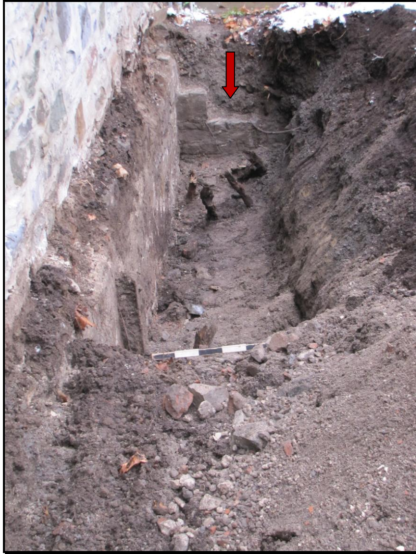
Figure 27. Vue de la tranchée et du vestige CeEt-838-2A2. Photo Serge Rouleau, en direction est, A11-14-09.
