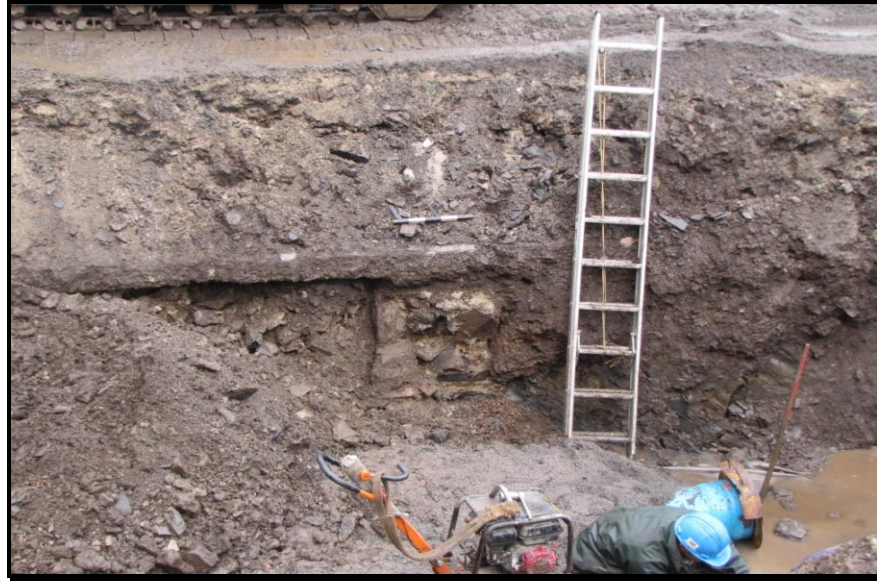
Figure 15. Découverte de la paroi sud d'un puits situé au milieu de la rue des Carrières CeEt609-3Y2. Photo Serge Rouleau, en direction est, A11-04-15.
