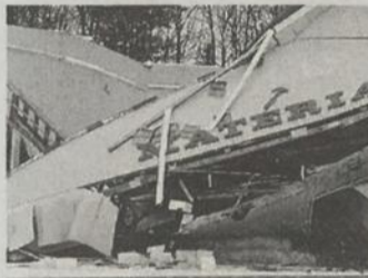
Le toit de Matériaux Lavergne de Saint-Étienne s'écroule sous le poids de la neige.
