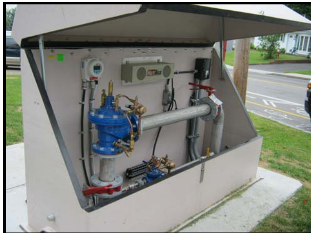
Figure 3-2 - Poste de contrôle de pression hors sol (Ville de Québec)
