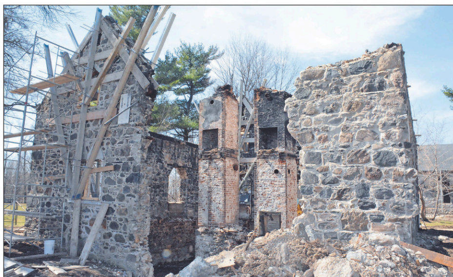
Selon l'entrepreneur, les conditions rencontrées durant le chantier étaient imprévisibles. La poursuite de 358 532$ équivaut à 8% de la valeur du contrat.
