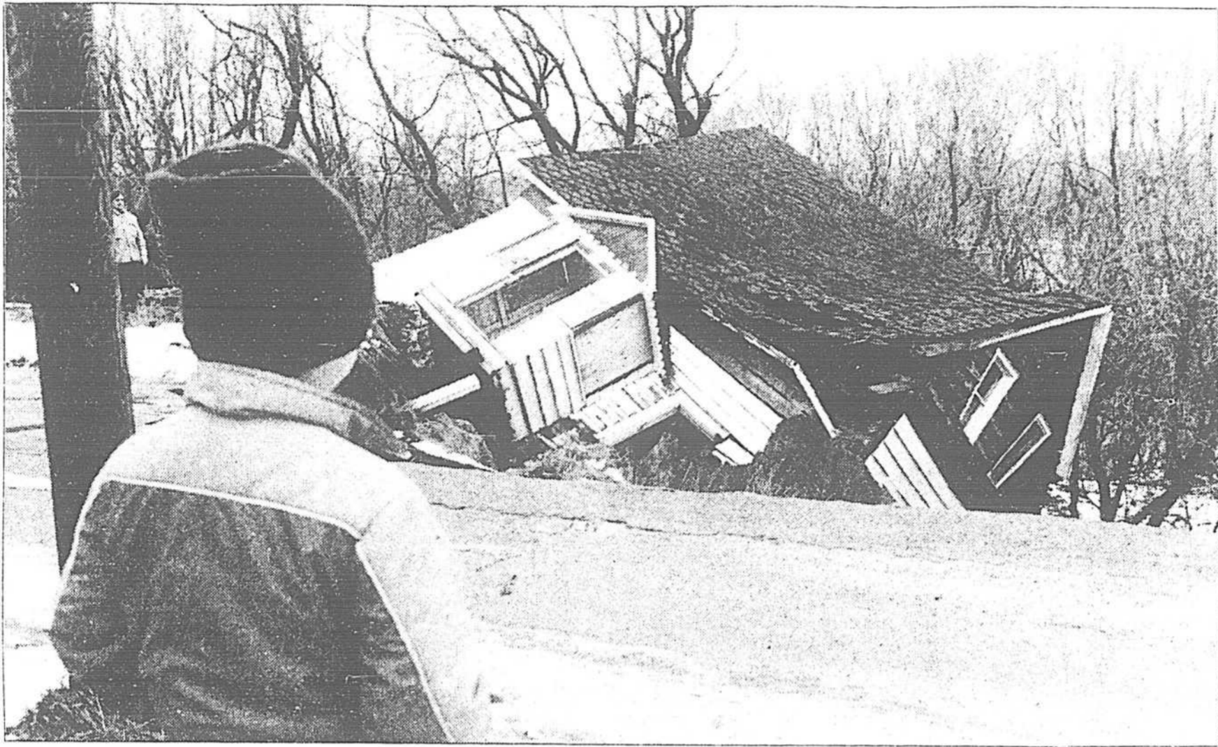
Un enfant regarde cette maison abandonnée glisser lentement vers le gouffre d'une quarantaine de pieds de profondeur apparu à la suite d'un glissement de terrain survenu le jour de Noël à Saint-Antoine-des-Laurentides.
