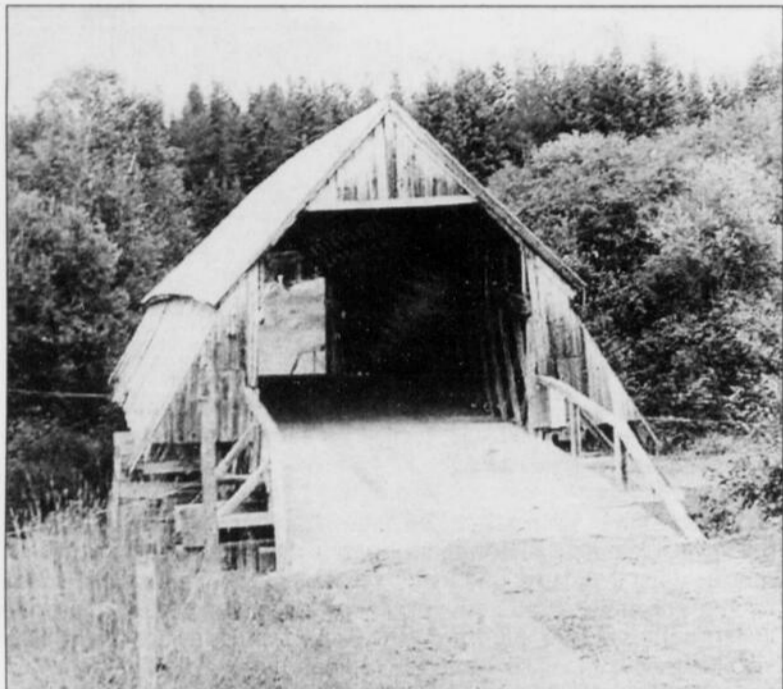
Le pont Painchaud a été construit en 1913. Au fil des années, il a su braver les intempéries. Toutefois, depuis 2007, son état était jugé persqu'irréparable.
