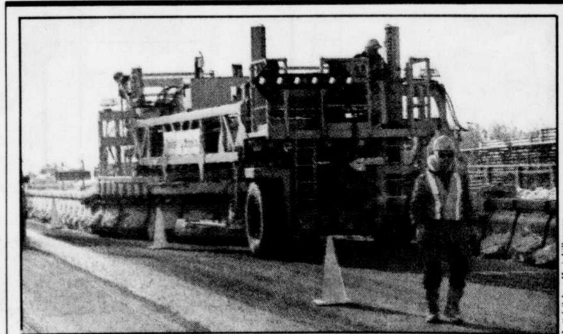
L'immense véhicule déplace une barrière de 364 blocs de béton pesant 635 kilos chacun sur une distance d'environ 400 mètres.
