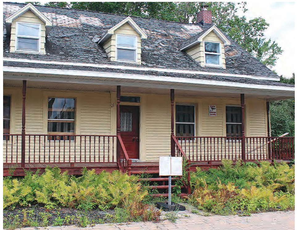
La maison Beauchamp, construite en 1855, est dans un tel état de délabrement qu'un avis de démolition a été autorisé par la Ville. (Photo : Frédéric Khalkhal)
