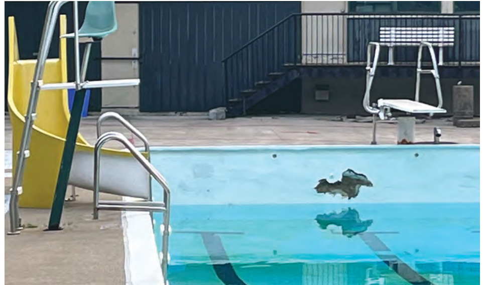
Le trou laissé par le morceau de béton qui s'est détaché est béant sur la paroi du bassin d'eau. (Photo : Jean-Christophe Noël)
