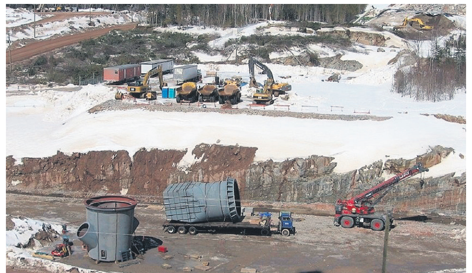
Les prochains mois seront très occupés sur l'immense terrain de la cimenterie à Port-Daniel. (Photo Gracieuseté)
