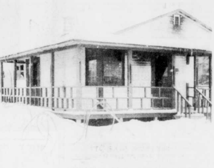
(Photo La Tribune par Richard Jean) On ne décelait que de rares traces de l'incendie de l'extérieur de la maison de M. Leroux, mais à l'intérieur, les pertes sont énormes dues aux flammes, à l'eau et à la fumée.
