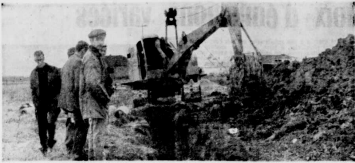
Début des travaux. — Cette photo a été prise au moment où on commençait les travaux d'aqueduc et d'égouts dans le village d'Omerville, hier matin. On voit déjà une partie des tuyaux qui ont été posés. Le contrat de creusage a été accordé à la firme Couillard de Coaticook. (Photo Noël Goyette, Magog)
