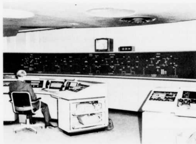
Figure 1 — Régulateur et tableau de contrôle du poste central.
