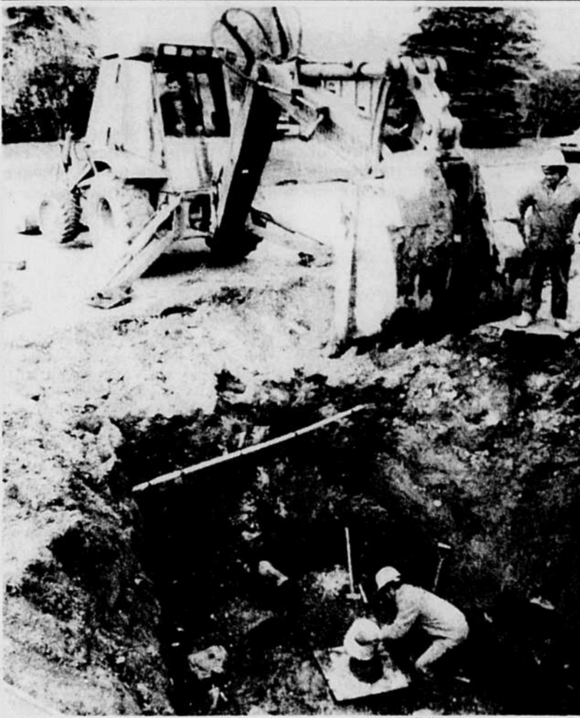
Phénomène typique à l'arrivée de la période de gel: des canalisations souterraines d'aqueduc font à l'occasion l'objet de fuites, comme cela a été le cas hier sur la rue Verdun, fraîchement pavée à neuf.
