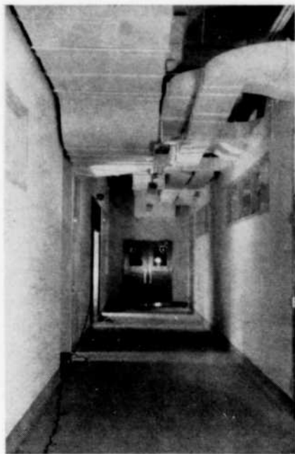
Fig. 6 — Conduites d'air dans l'édifice.
