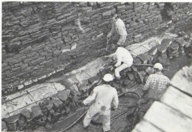
Figure 30 — Un épaulement de béton ancré au roc et retenu par un muret de pierre sèche est coulé à l'extérieur des murs pour leur donner une meilleure assise (photo Roger Picard)
