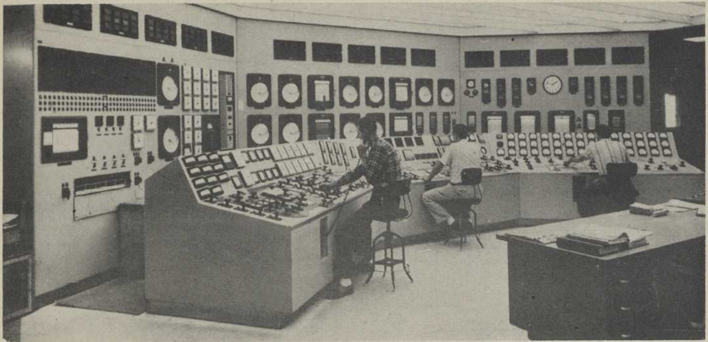
FIG. 1 — CONSOLE PRINCIPALE DES CONTROLES DE LA CENTRALE.
