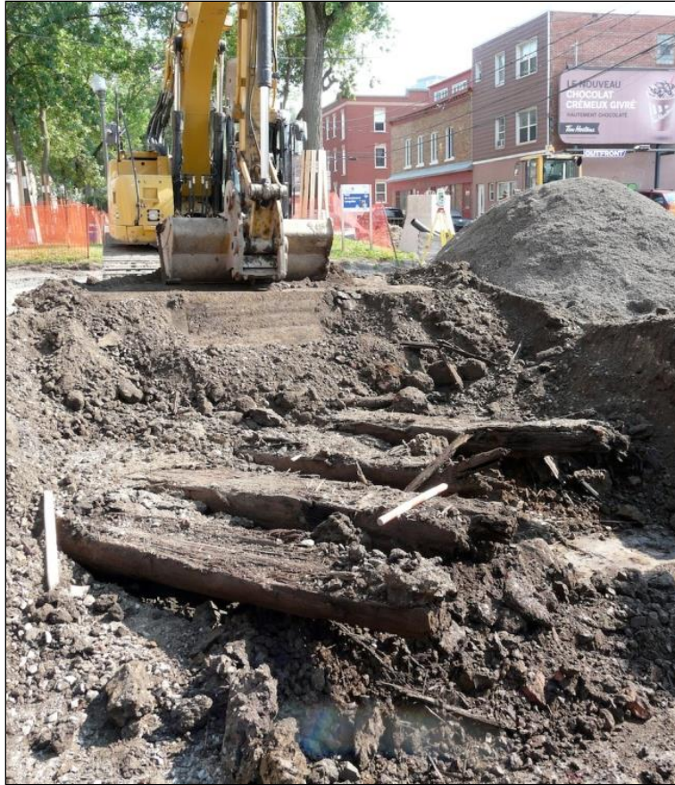
Photo 43. Vue d'ensemble de madriers (2G100) et de la pierre concassée (ballast) mis au jour dans la sous-opération 2G, vers le sud (CeEt-931-2015-2-004)
