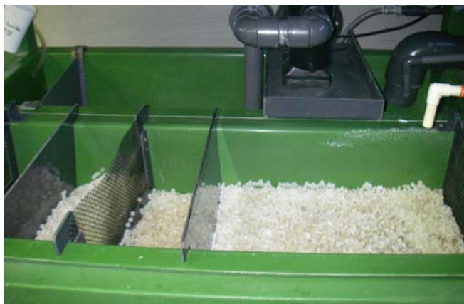
Photo 1. Sections du filtre biologique.
