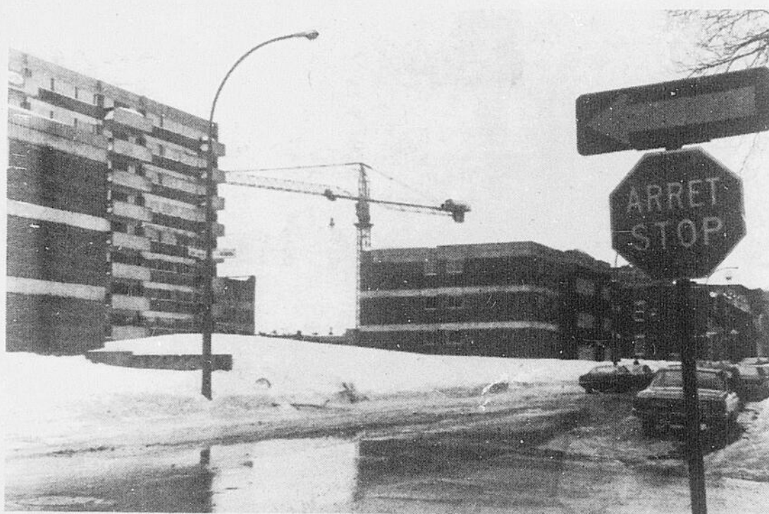
UN CHANTIER fermé d'un projet de logements à loyers modiques de la ville de Montréal. Entrepreneur: Secant Construction.
