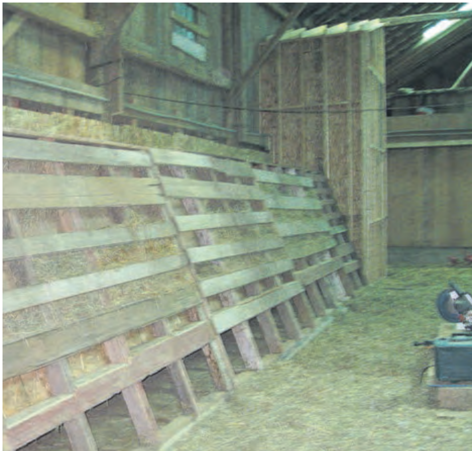
Ce séchoir à foin est doté d'un plénum d'admission d'air muni d'un capteur solaire. Le plénum positif avec ouvertures au sol a été placé en bordure du mur de la tasserie; il a été incliné d'un seul côté pour décaler les espaces entre les balles de foin au moment de leur mise en entreposage. (Photo : Yves Bédard, MAPAQ)
