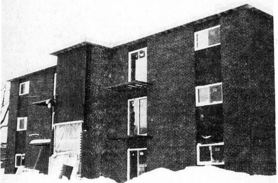
Le complexe de logement sur la rue Wellington prend forme depuis le début de sa construction en novembre dernier.
