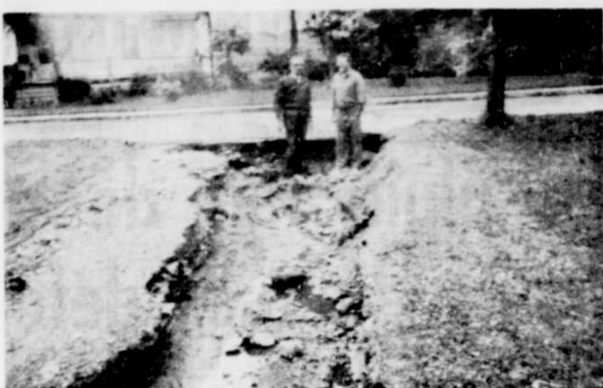
LA TEMPÊTE a fait aussi des siennes dans les limites de la ville d'East Angus, en se taillant un canal d'une profondeur que l'on peut constater à l'entrée de la propriété de M. Maurice Marquis, rue St-Jean. Ce dernier examine en compagnie de son voisin, M. Gérard Roy, les dommages causés par la pluie de samedi soir à son entrée de cour.
