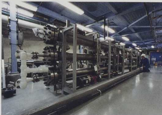
Une petite partie de la tuyauterie qui permettra d'injecter et de récupérer les 2 tonnes de chlorure de magnésium dans les précieuses 1 000 tonnes d'eau lourde.
