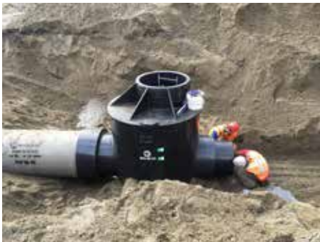
Unité hydrostatique servant à ralentir l'eau de pluie qui arrive au bassin de rétention.
