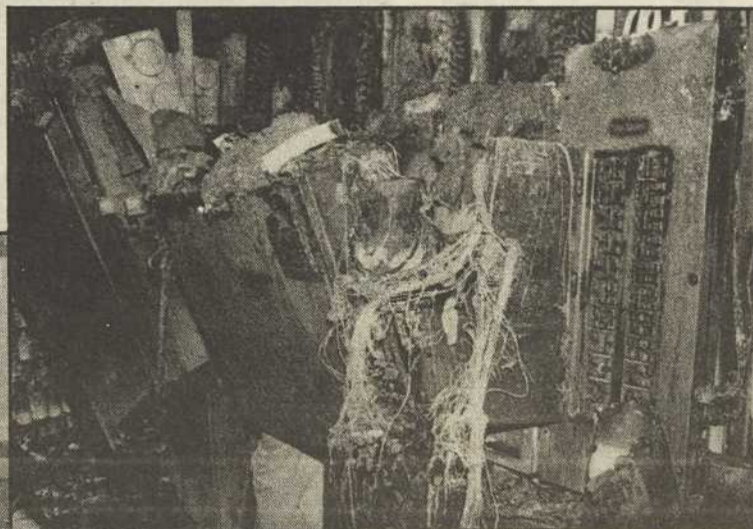
Les installations électriques devront être remplacées, tellement elles ont été endommagées.
