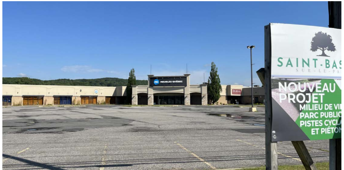
Un comité de vigilance a été créé afin de veiller aux travaux de démolition et de construction sur le site de Maison Éthier. (Photo : archives)
