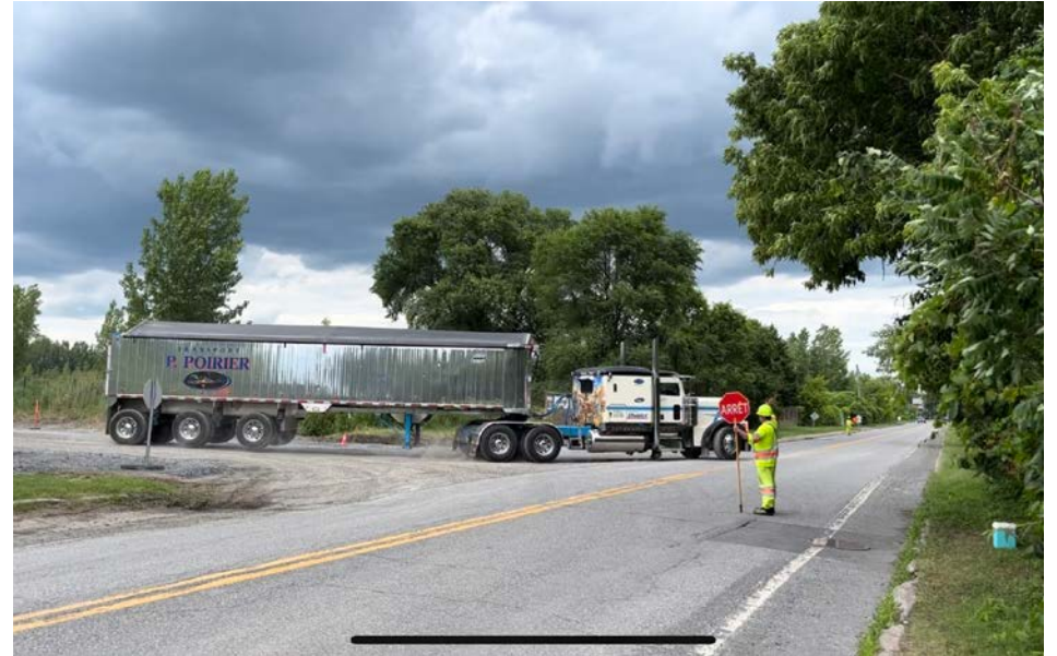
Des camions lourds entrent et sortent du chantier de Northvolt pendant les travaux. (Photo : Frank Jr Rodi)
