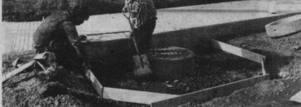
Sur la rue Ste-Catherine: on poursuit la fabrication des dalles de nivellement. Après quoi, on donnera une première couche d'asphalte. Plus au nord de ce secteur, soit sur Lemoyne entre Chemin Chambly et St-Jacques, ainsi que sur St-Alexandre entre Lemoyne et De Gentilly, on en est à la deuxième couche. Ce qui veut dire que le circuit d'autobus et la circulation qui étaient détournés sur De Gentilly reviendront très bientôt sur la «nouvelle» rue Lemoyne.
