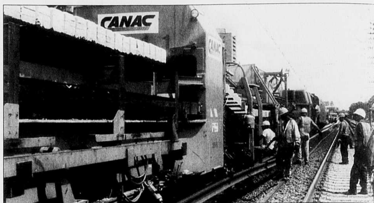
Ce curieux appareil, baptisé P-811 et acquis au coût de huit millions, fait des merveilles sur une voie ferrée pour remplacer les traverses et les rails, sans vraiment interrompre le service sur une longue période. Il n'existe que deux appareils semblables en Amérique du Nord; l'autre est la propriété d'Amtrak, aux États-Unis.
