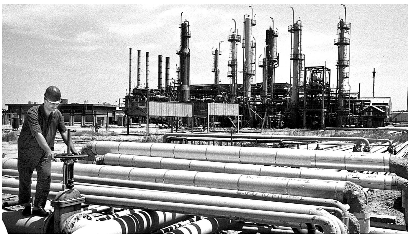
Kirkouk, la plus importante station de pompage en Irak. Aujourd'hui famélique, la production irakienne pourrait atteindre 6 millions de barils par jour dans un horizon de cinq ans.
