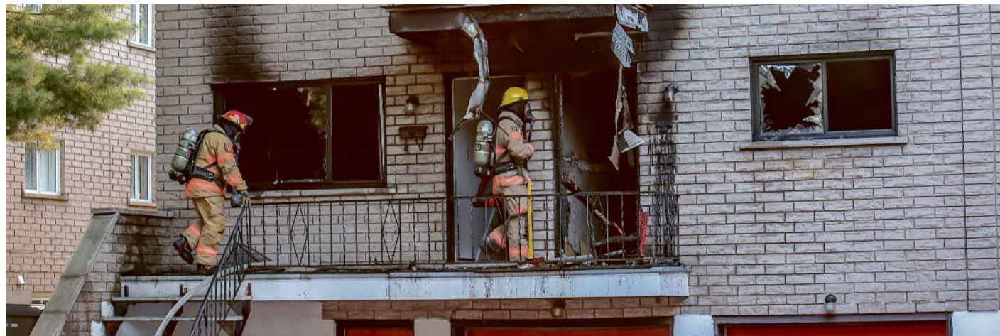
À l'arrivée des pompiers, l'appartement de la rue des Trembles était la proie d'un violent incendie considéré comme accidentel. Photo Steve Gauthier | Les 2 Rives ©
