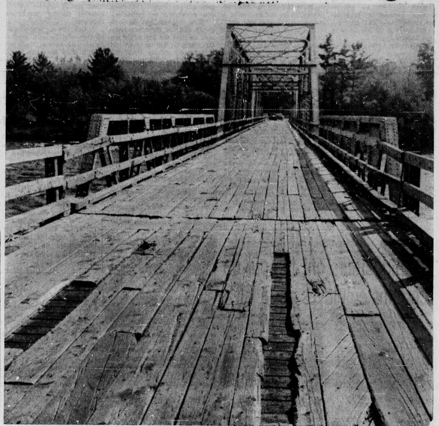
La réfection du pont s'imposait...
