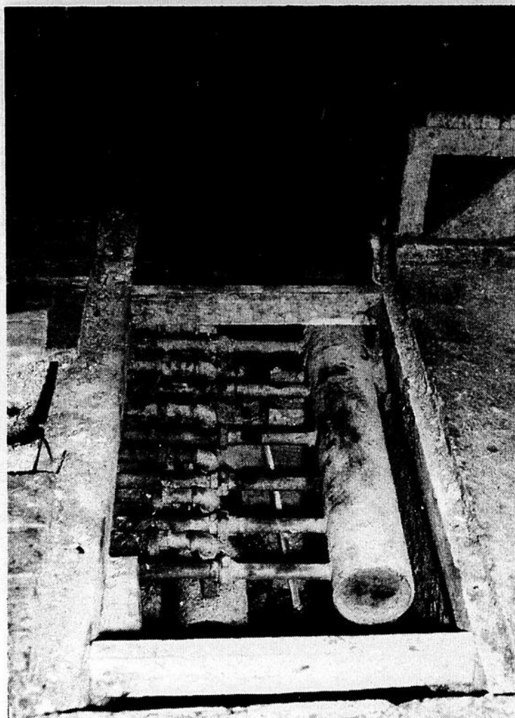
Vous voyez sur cette photo, les tuyaux qui servent à faire congeler la glace de la patinoire de l'aréna municipal de Matane
