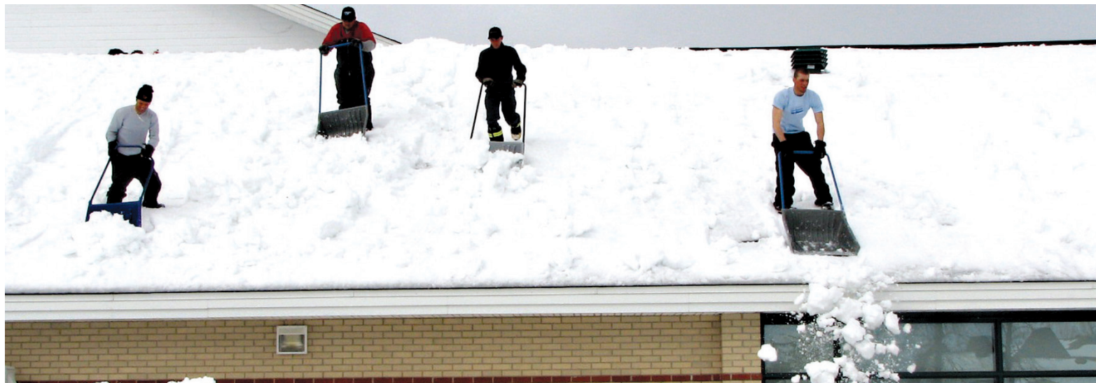
La Commission scolaire des Draveurs a dû déboursier 675 000 $, l'hiver dernier, pour nettoyer les toits de ses établissements.
