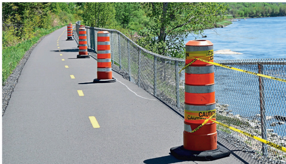
En plus des deux ponts, le MTQ devrait réparer cette section affaissée en 2019 selon la Ville de Beauceville et la MRC Robert-Cliche. (Photo L'Éclairer Progrès - Archives)
