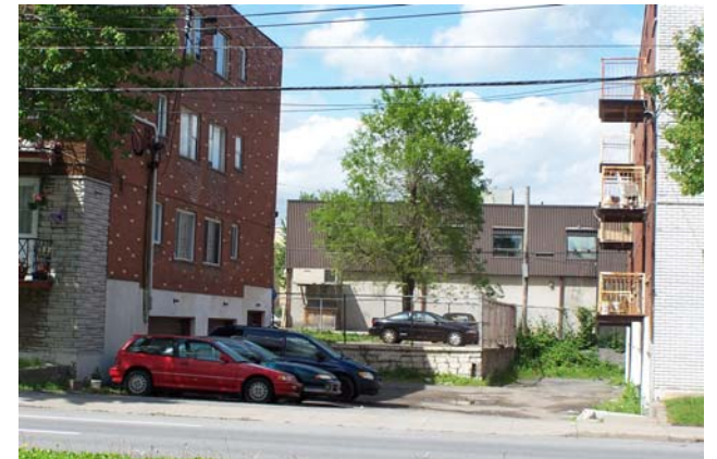
Vue sur des balcons rouillés
