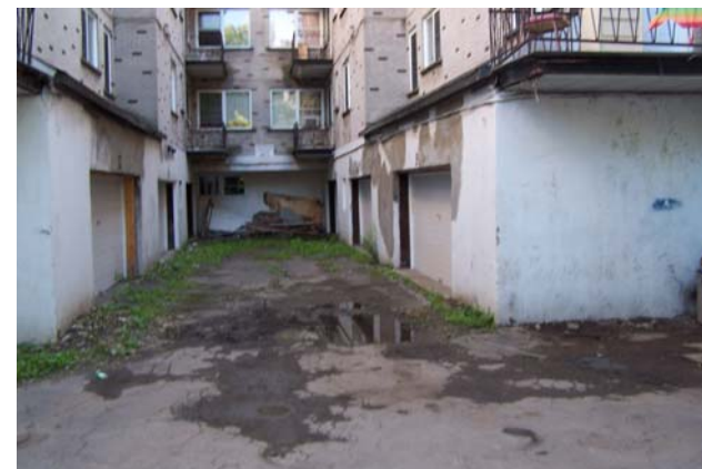
Cour d'un immeuble : garages condamnés à la suite d'un accident en 2004
