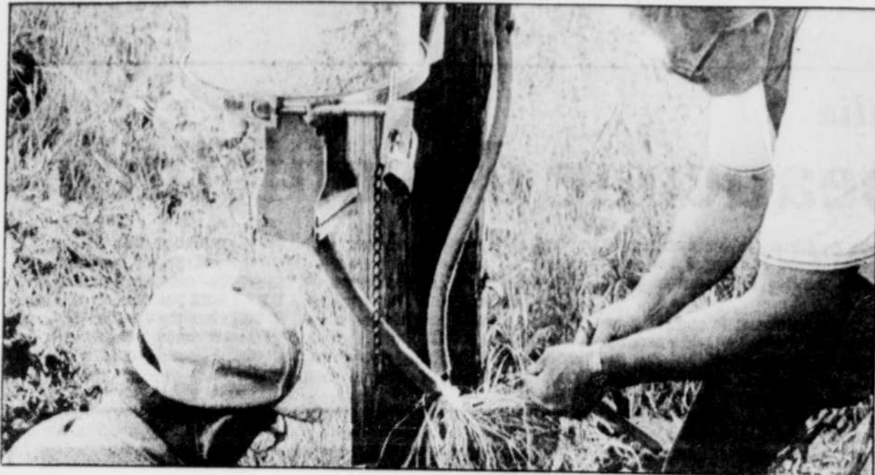
Un autre acte de vandalisme a perturbé les communications à l'aéroport de Sault Ste-Marie. Deux employés de Bell Canada s'affairent à réparer les dégâts.
