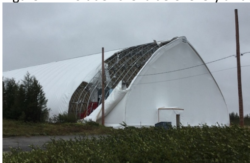
Figure 11 : Toit de l'aréna de Chevery arraché par les vents
