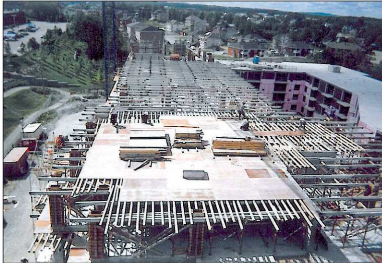
Les Entreprises Jean Baillargeon ont effectué les coffrages sur le chantier des Seigneuries du Carrefour en 2006.
