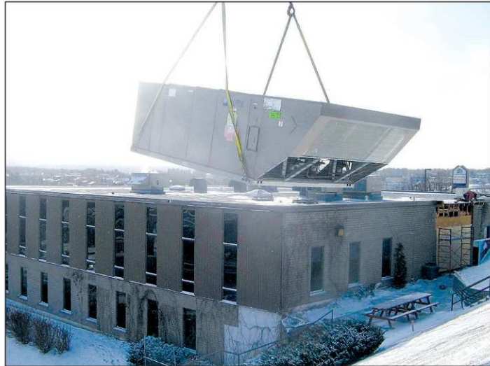
Beaudin Le Prohon a réalisé les travaux pour la ventilation, la climatisation, les centrales d'air géothermique et les unités de toit pour l'édifice de Cima+ en 2008-2009.
