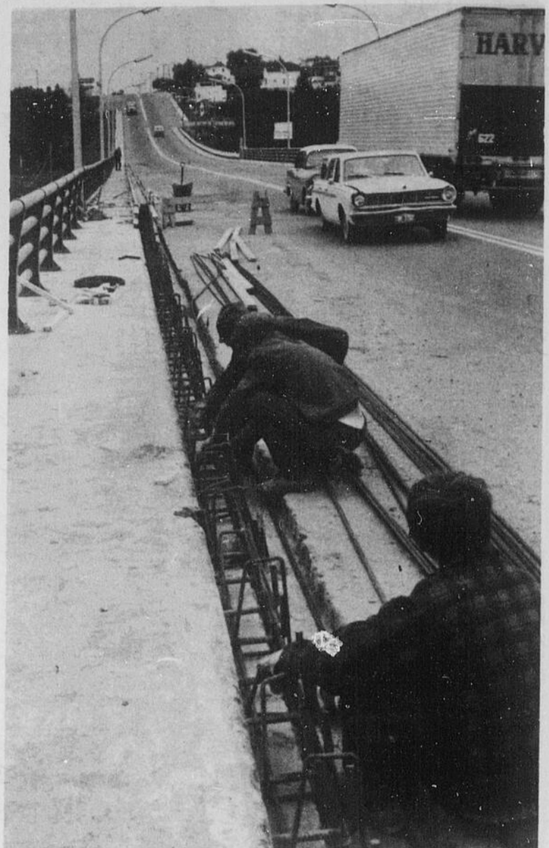
Le ministère de la Voirie procède présentement à des travaux sur le pont Carcajou, qui surplombe la rivière Petite-Décharge. L'on construit un accotement de ciment d'environ 20 pouces de hauteur. Les automobilistes jouiront alors d'une meilleure protection.
