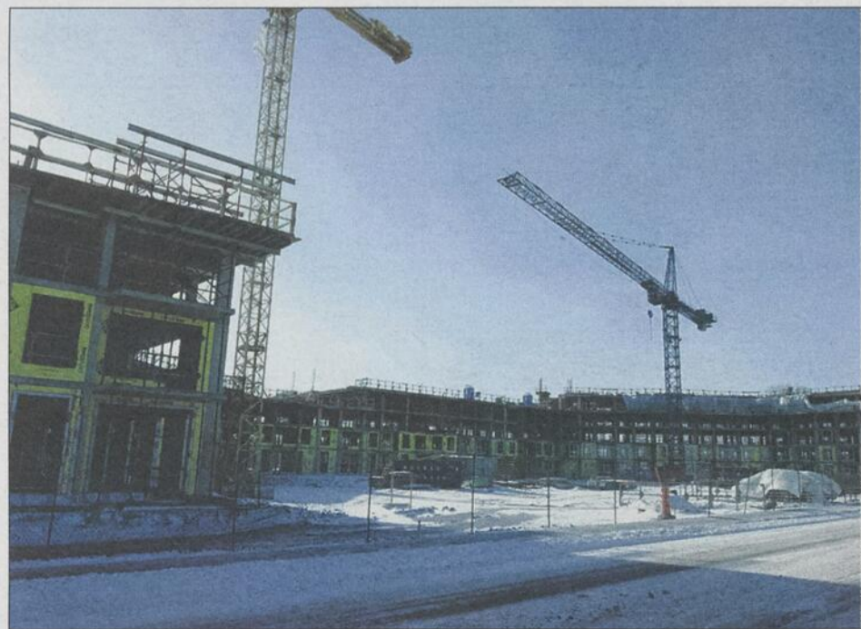
Le Groupe Maurice a donné le coup d'envoi à son nouveau complexe résidentiel pour retraités, La Cité des Tours. Un investissement de 30 M$.
