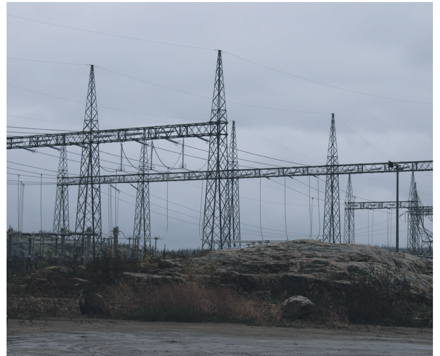
Un épisode de verglas a endommagé des lignes de transport d'Hydro-Québec reliant les centrales de Romaine-3 et Romaine-4. Les travaux sont maintenant terminés. Photo Vincent Rioux-Berrouard
