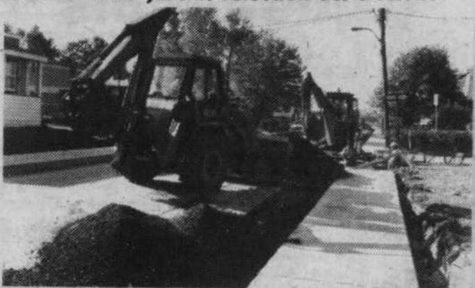
Bien qu'ils s'effectuent à proximité des autres chantiers, les travaux actuellement en cours sur la rue St-Jean ne sont pas faits dans le cadre du programme d'assainissement des eaux. Il s'agit plutôt de la deuxième phase du programme triennal de réfection des trottoirs du Vieux-Longueuil commencé l'an dernier et initié par la direction du Génie et Travaux publics de la Ville.
