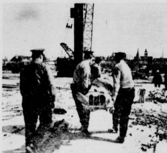
Des policiers transportent l'une des victimes de la chute d'une poutre sur le chantier de démolition du pavillon russe à l'Expo 67.
