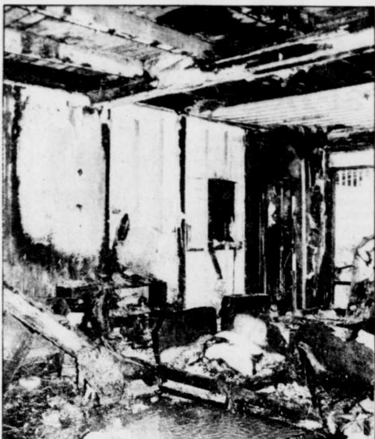
Le rez-de-chaussée du 554, Franklin, à Québec, a été complètement rase par les flammes.
