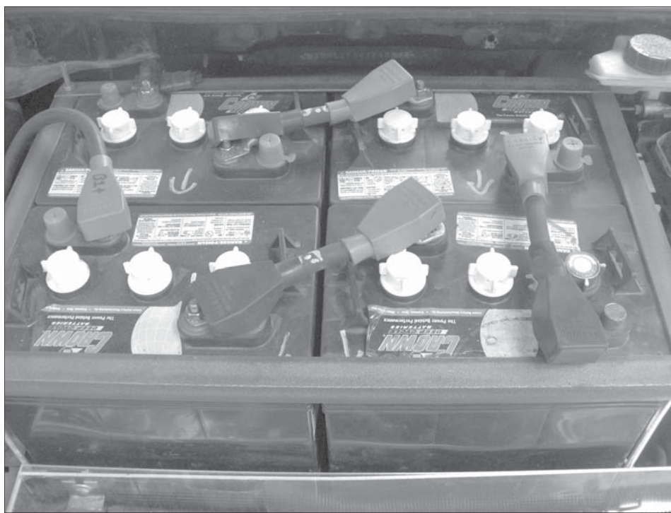
Un grand plan sur les batteries au plomb de la voiture. Les emboûts blancs servent à insérer l'eau, puisque les batteries au plomb sont de type "flood".
