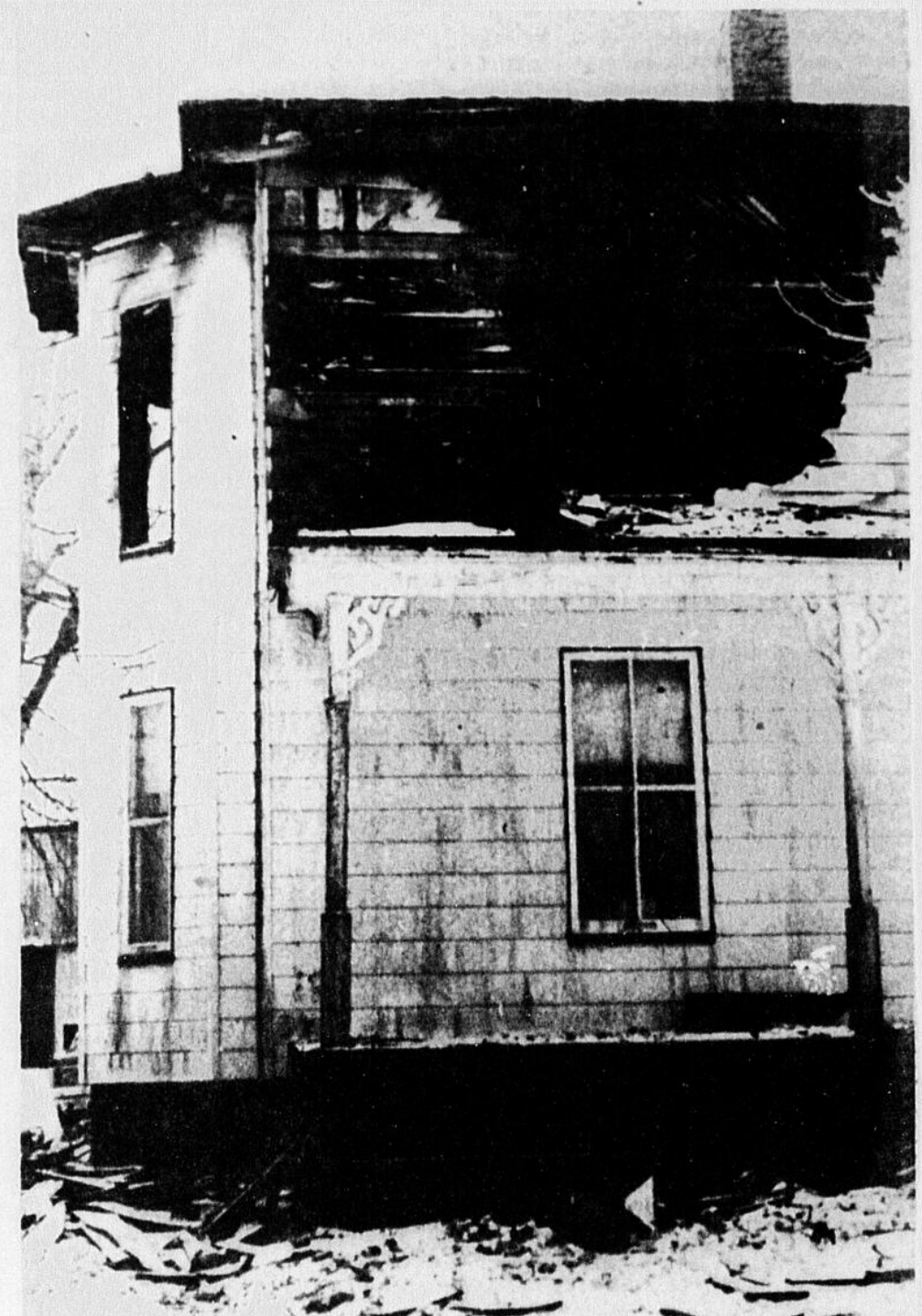
Un incendie criminel est la cause des dommages à la résidence de M. Arnold
