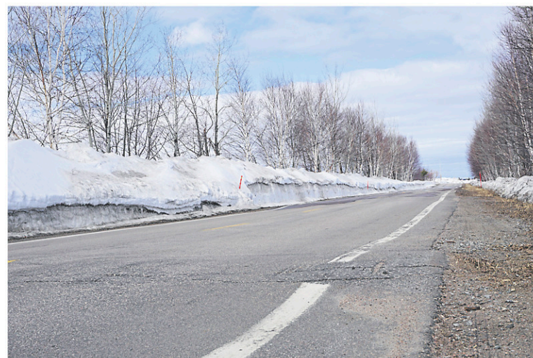
La route de Vauvert est dans un piteux état depuis plusieurs années. —PHOTO LE QUOTIDIEN, MEGHANN DIONNE
