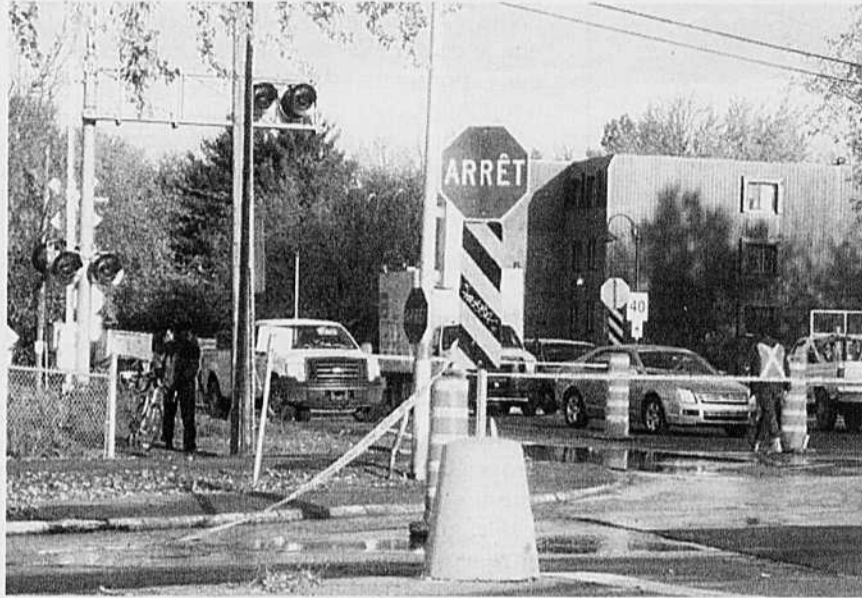
L'une des fuites d'eau sur le boulevard Fort-Saint-Louis, à la hauteur du boulevard de Montarville.
